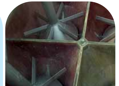
Módulos del Filtro DynaSand® en tanque de concreto
